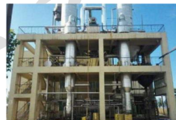
江西新余西林森光电科技有限公司 电镀废水 1T/H MVR 蒸发器 1套
