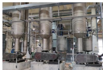
广州市环境技术设备有限公司（广汽集团） 物化废水，焚烧废水 12T/H MVR 蒸发器 1套+12T/H三效蒸发器 1套
