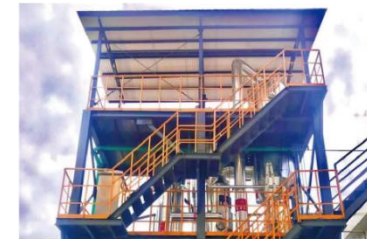
励福（江门）环保科技股份有限公司 含盐废水MVR蒸发处理项目 1.3T/H MVR蒸发系统
