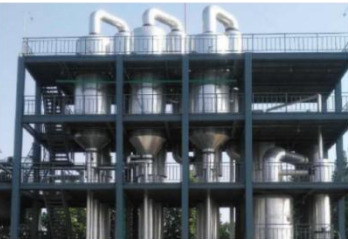
广州国宏新材料有限公司（久泰集团） 合成纤维单体/聚合体制造 30T/H 三效+单效蒸发系统
